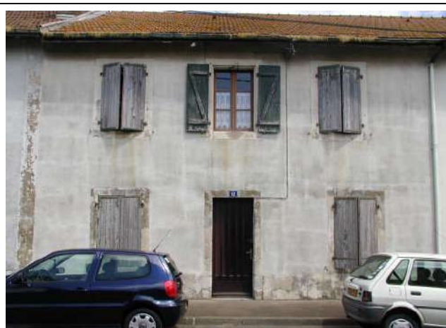
Façade peu entretenue
